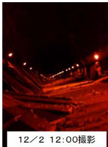
天井板崩落後の様子
